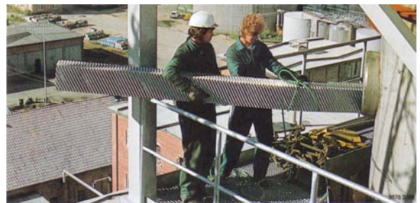
Foto 1. L'installazione di un elemento di riempimento strutturato in una colonna di grandi dimensioni
